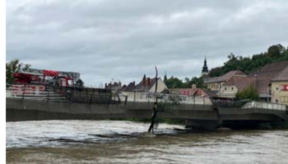
Auch das Hochwasser machte vor dem Gemeindegebiet der Stadtgemeinde nicht halt und verursachte gravierende Schäden. Um weitere Schäden zu vermeiden, mussten Verkläusungen gelöst werden, wie dies hier bei der Murbrücke ersichtlich ist.
